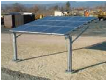
Pensilina per sostegno moduli fotovoltaici
